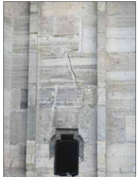
■ 5. kép: Közel függőlegesen eltört és szétcsúszott kváderek a déli mellékhajó falába illesztett lépcsőház ablaka fölött. © KÁZMÉR Miklós
